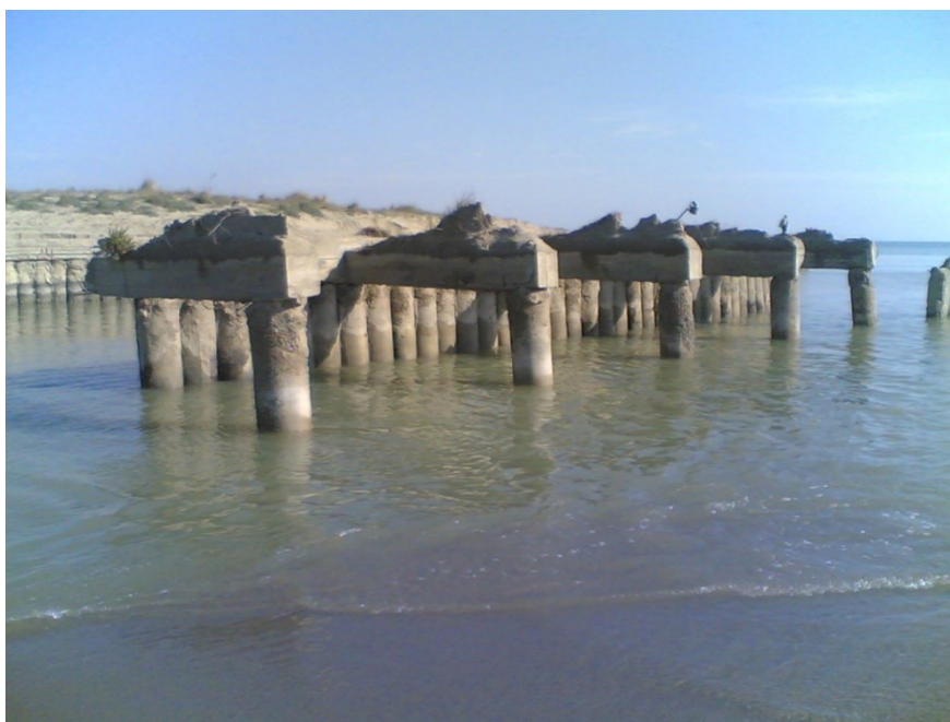
Le arginature in cemento armato del Torrente Galaso divelte dalla massa d'acqua alluvionale proveniente dall'entroterra. Si ha qui tutta la misura della potenza distruttiva di un'onda d'urto che combine in un unico evento fisico la quantità, la persistenza e la concentrazione della massa d'acqua interessata. (Foto R. Perrone)
